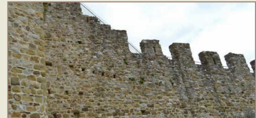
Merlatura - insieme di merli, interruzioni simmetriche della muraglia, disposti su torri o cinte murarie, che consentivano al tiratore di ripararsi dagli attacchi
